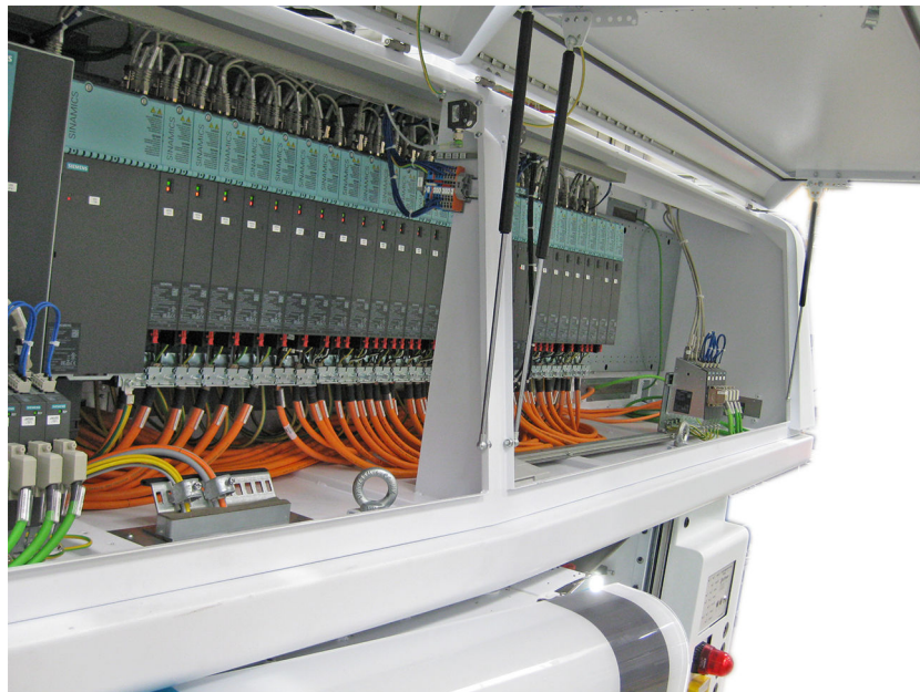
Exemple : Portes des armoires électriques d'un multibroche
